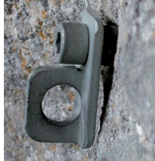
Eine Sanierung ist hier dringend nötig.
