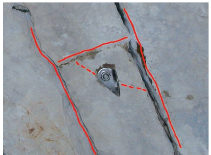
Zu geringe Abstände sowie Risse im Gestein
