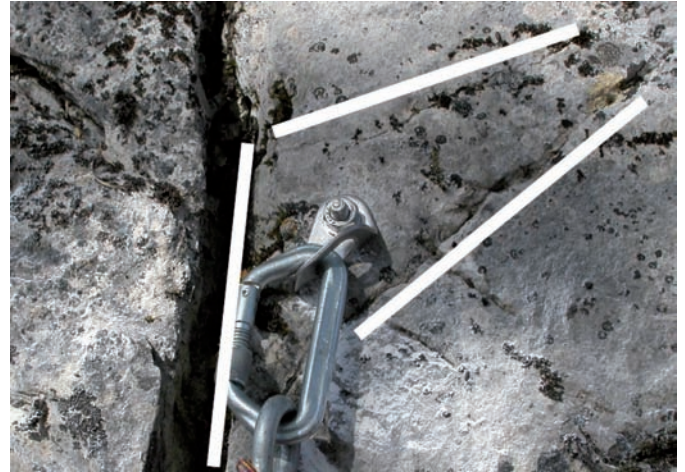
Zu geringer Abstand zum Riss
